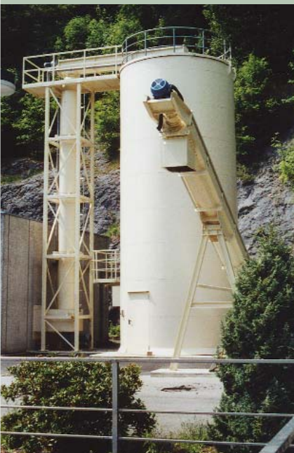
Klärschlamm-silo 100 m 3 Seelenloser Senkrechtförderer
