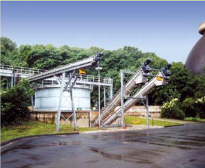
Klärschlamm-silo 380 m 3 mit Austragungs- und Verladeschnecke in Tandemausführung
